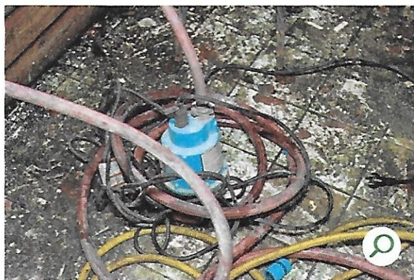
Bewohner des Blumenviertels müssen sich um die Trockenlegung ihrer Kelle selbst kümmern – mit Pumpenanlagen wie diesen.
